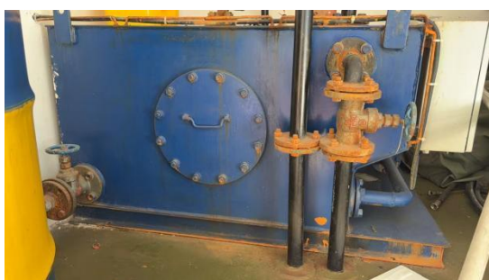
油污水收集柜
